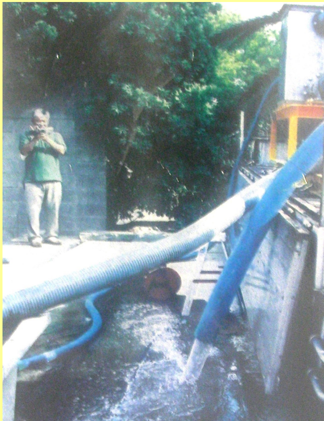
NRシステムで汚水を処理している様子
